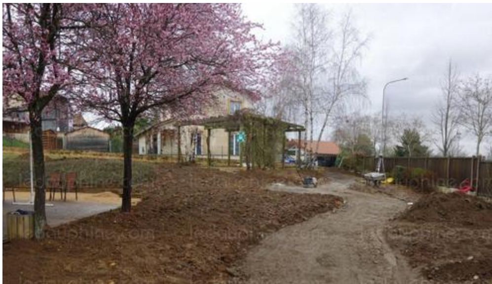
Le chantier en cours du Jardin des Hêtres à proximité de Lyon (Résidence du Cercle, réseau Oméris, 14 boulevard des Oiseaux à Sathonay-Camp).
